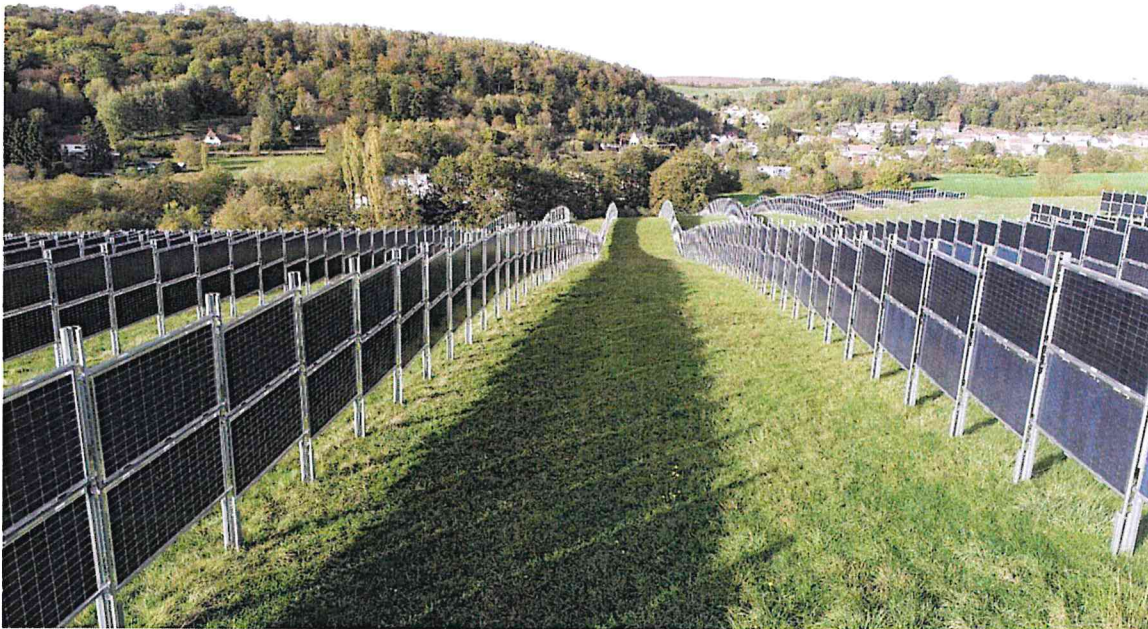
Abb. 1 – Modulreihen mit 10 m Reihenzwischenraum im Solarpark Eppelborn Dirmingen
